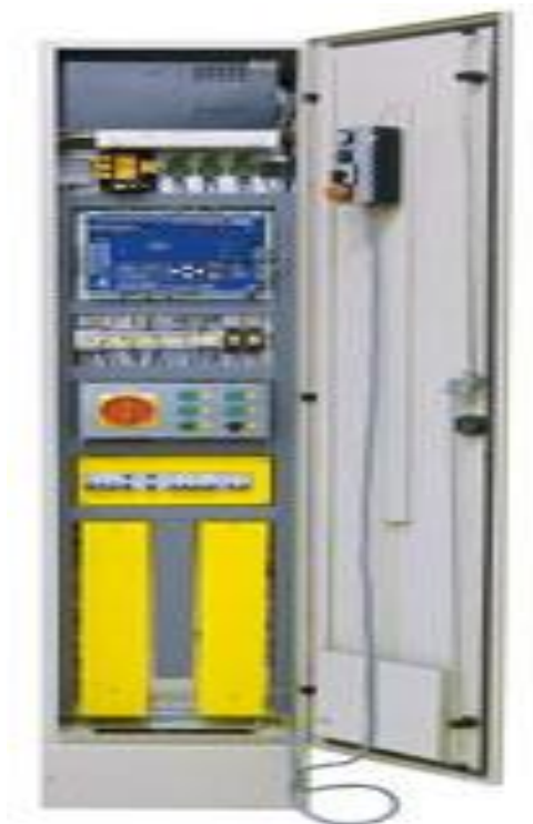
Fig. 3. Kontroll kabineti i ashensorit
